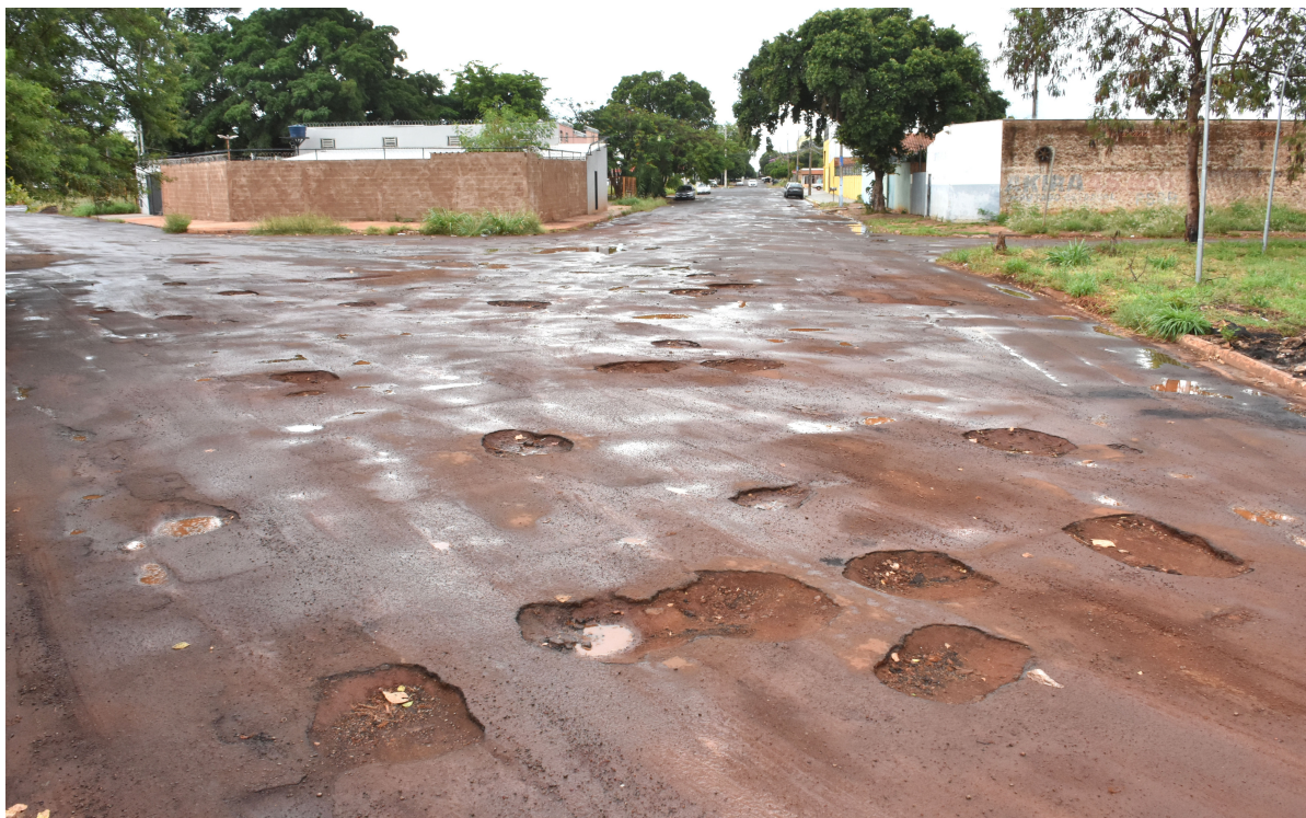
Ruas da Capital no “estilo de gestão Adriane Lopes” – Buracos na Rua dos Boticários. (Foto: Gerson Oliveira/Correio do Estado).
